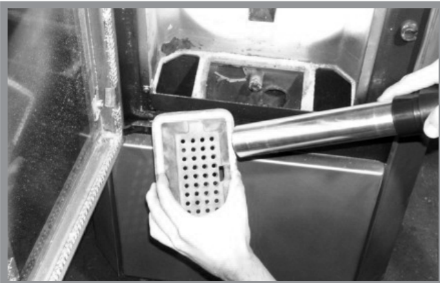
Abb. 12b: Reinigung der Luftöffnungen mit einem Staubsauger
